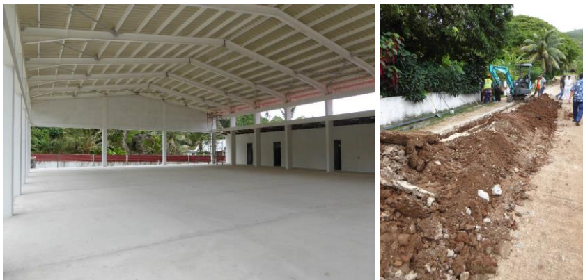
Visite du village de Hauti et présentation de l'avancement des projets de construction de la salle omnisport et de rénovation du réseau hydraulique du village de Hauti
